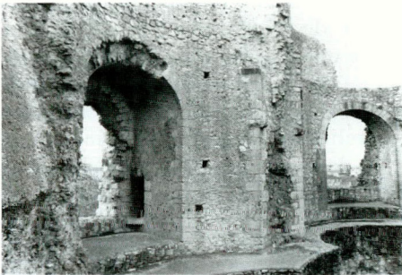
Figure 19. Intérieur de l'abside sud-ouest au 2 e étage, fenêtre, et à l'arrière, colonne arrachée et fenêtre d'axe de l'abside nord-ouest, en bout de salle (état en 1979).
