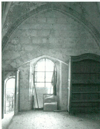
Figure 12. Étampes, Notre-Dame, mur occidental de la salle supérieure du bâtiment nord. L'arc de décharge et l'arc formeret ne sont pas lancés suivant le même axe.
